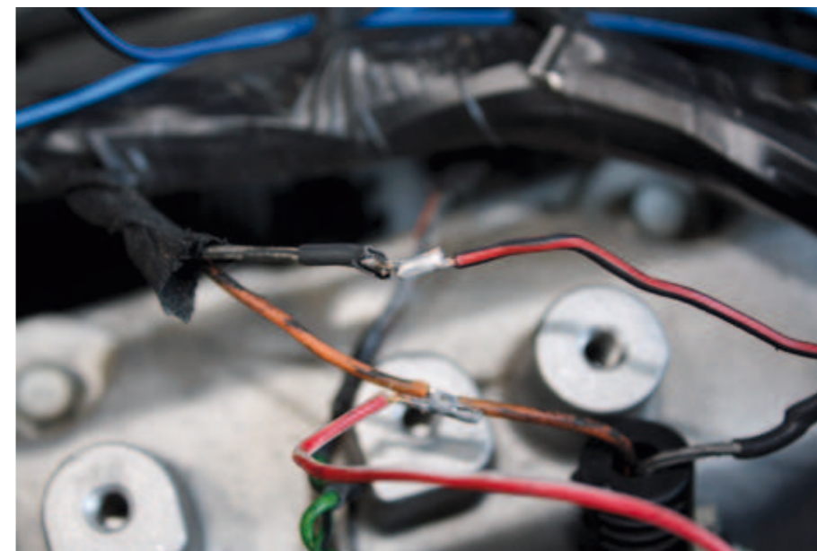
Schlimmer geht es nimmer: Kabel einfach verlötet. Das hält maximal bis zum ersten Schlagloch. Auch im Verfahren in Bremen wurde an den Fahrzeugen schwere Mängel festgestellt.
